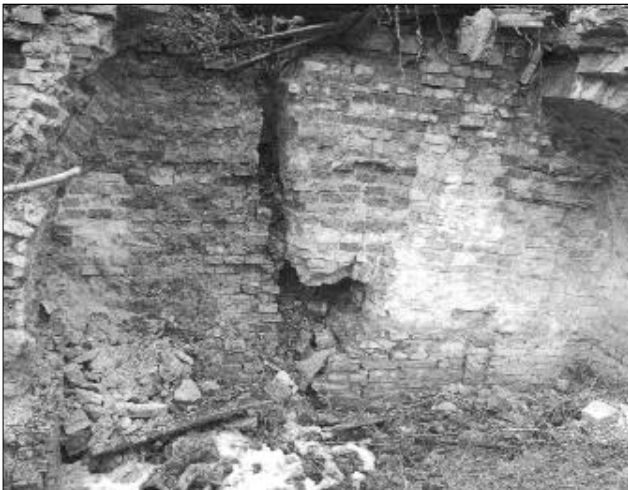
Поздовжні тріщини на південному фасаді льоху. Сучасне фото
